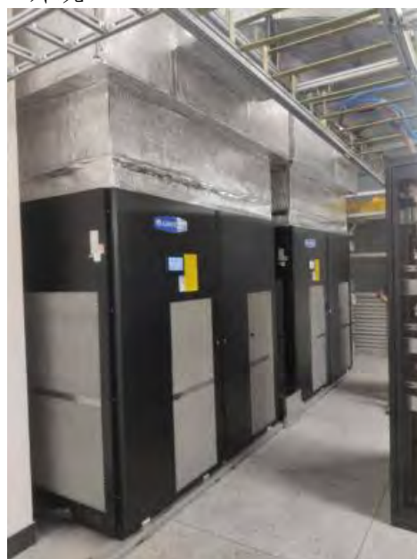
图现场内机安装情况
